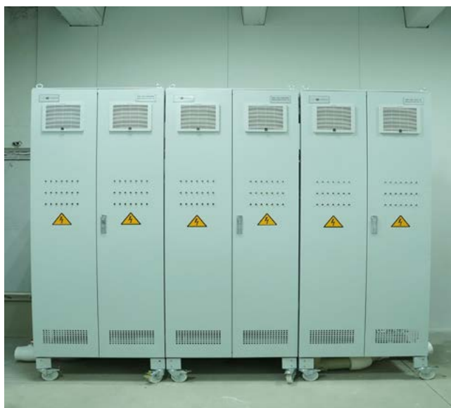
Рис. 19. Система балластной нагрузки мощностью 50 кВт.
